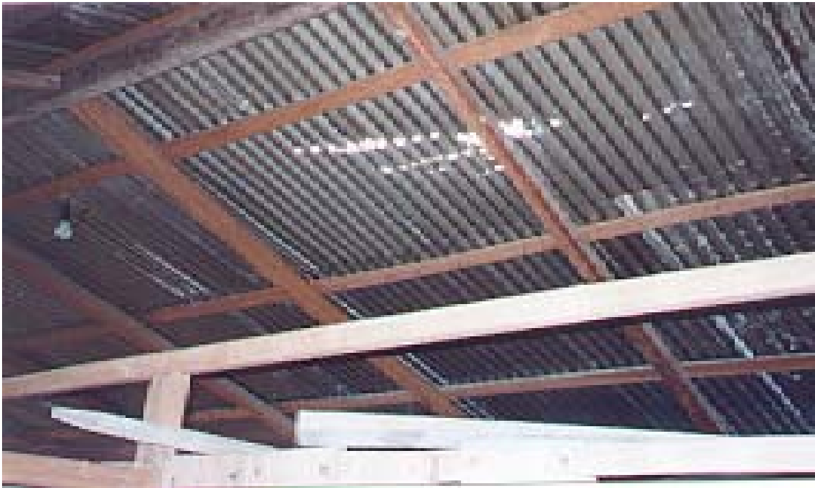
FOTO 9: Impacto de proyectil en techo de vivienda (1) en Napipí
