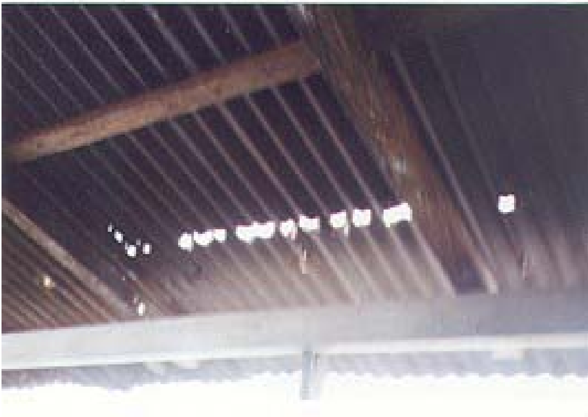
FOTO 10: Impacto de proyectil en techo de vivienda (2) en Napipí
